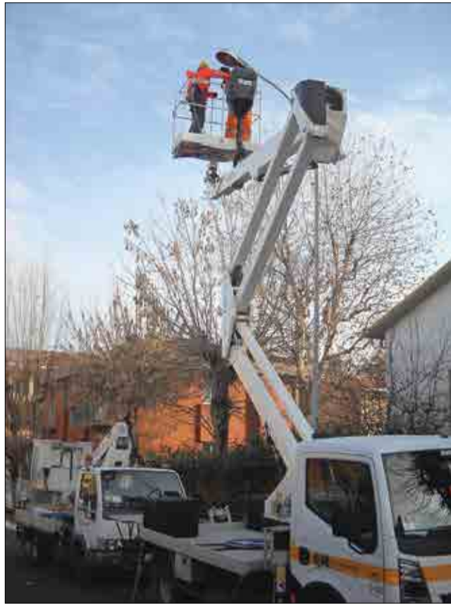
■ ■ ■ Tecnici di CPL all’opera per la manutenzione della Pubblica Illuminazione nel comune di Zola: per tutti i 2500 punti luce è prevista la georeferenziazione
