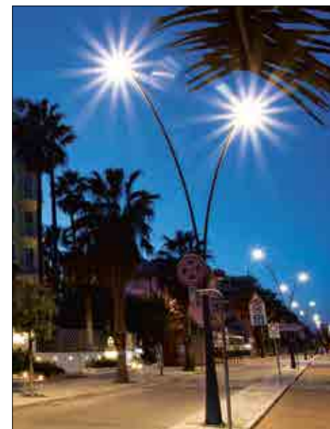
La riduzione di flusso luminoso sarà realizzata con l'impiego di riduttori puntuali e di quadri centralizzati
